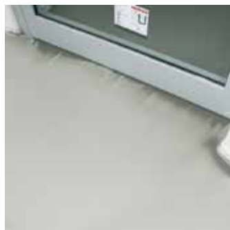
Farbänderung durch Zugluft
