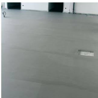
Glanzgradunterschiede in der Versiegelung
