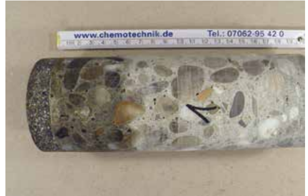
Stark verölter Beton unter Magnesiaestrich
