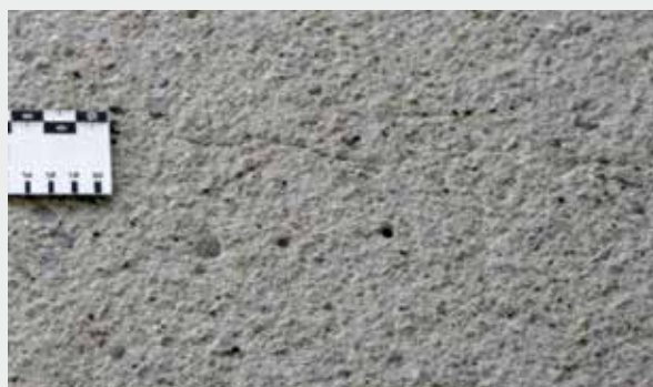
Fräs-/Strahlbild ungeeignet: Reste von Feinmörtel, kein Korngefüge
